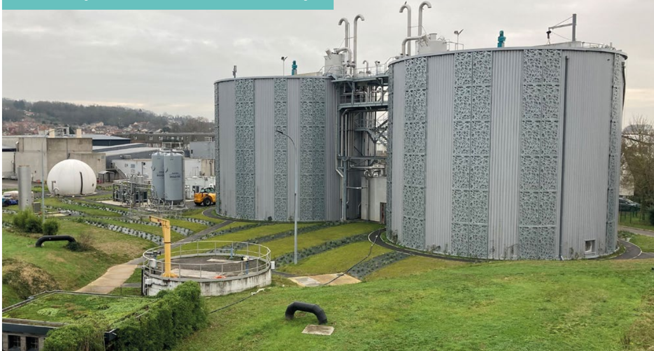
Les nouveaux digesteurs et les installations de valorisation du biogaz
