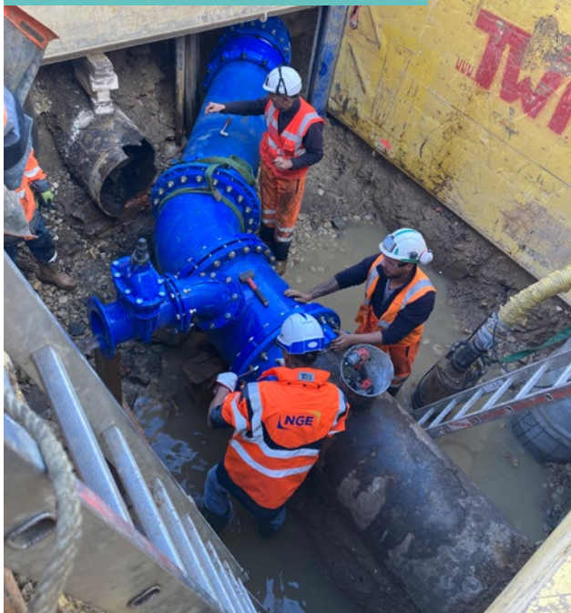
Renouvellement d'une conduite en fonte grise de 600 mm sous la future plateforme du trolley
