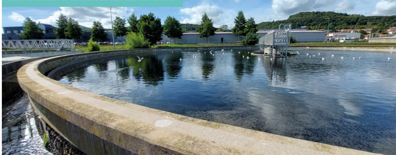
Bassin de la station de traitement des eaux usées de Maxéville
